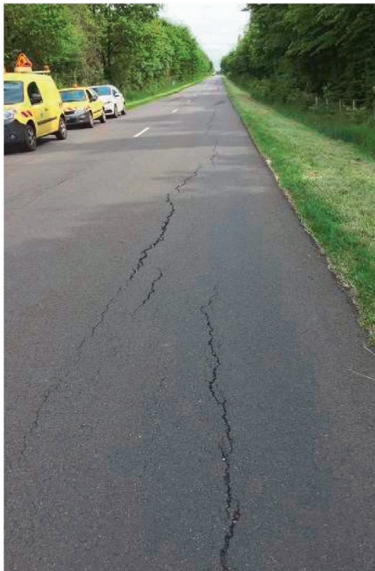
Vue d'une fissure longitudinale liée au RGA
